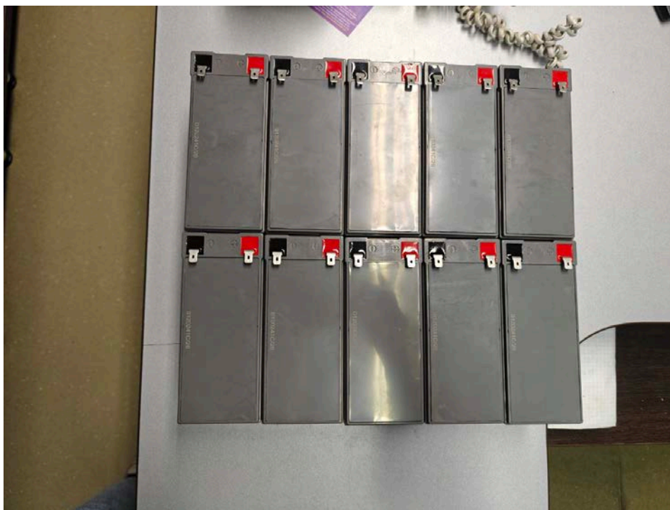
Рисунок 2 – АБ FIAMM 12FGHL34 10 штук вид сверху
